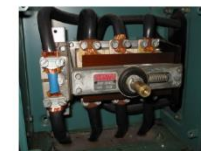
På bilden passerar PEN-ledare genom en delbar nollplint. Plinten har efter en anmärkning vid revisionsbesiktning förbikopplats.
